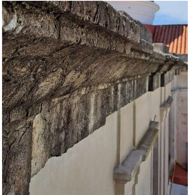
Ilustración N°34 grietas y fisuras
