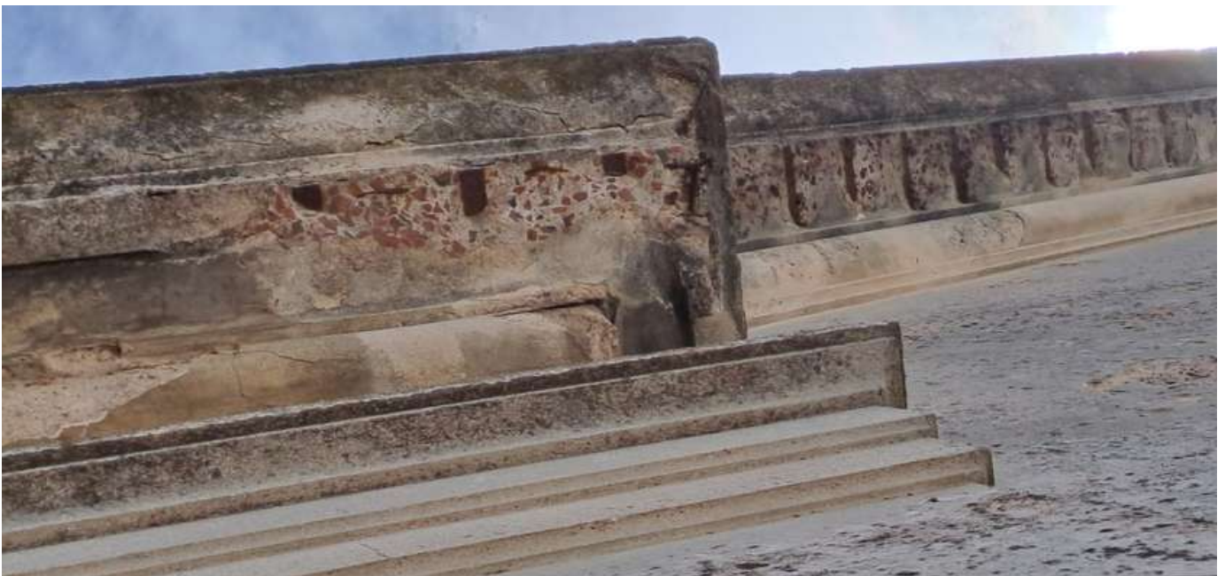
Ilustración N°32 Hierros de anclaje de cornisas expuestos
