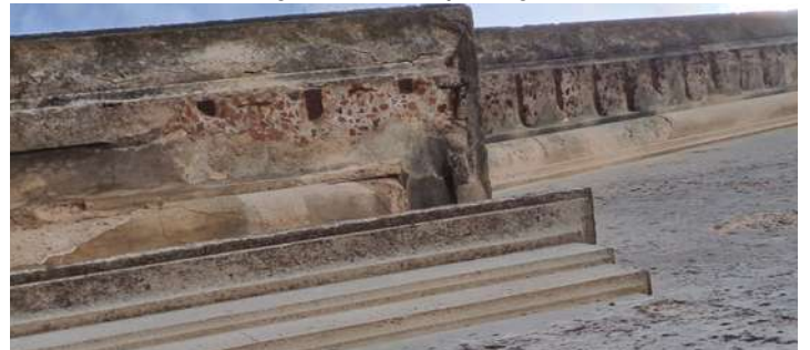
Ilustración N°58 Hierros expuestos de cornisas
