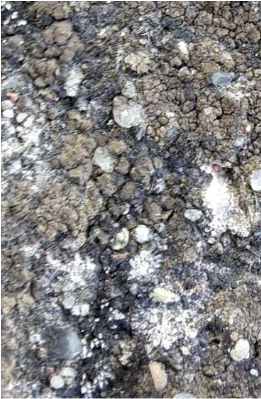
Ilustración N°33 Disgregación del material
